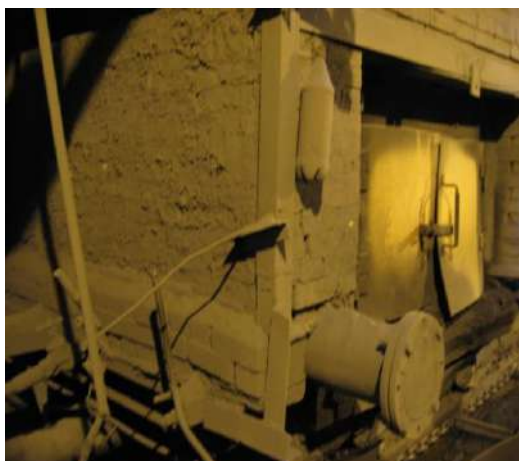
Фото 2. Водогрейный котёл КВр-4 (фронтальная часть)
