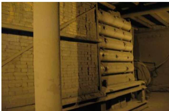
Фото 3. Водогрейный котёл КВр-4 (боковая часть)
